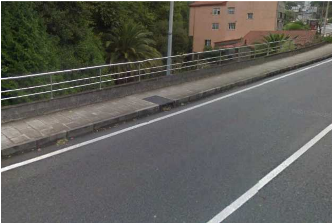
Imaxe de unha das tragadeiras instaladas polo Servizo Municipal
