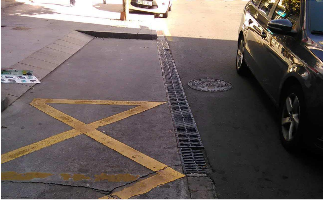
Reixas existentes na actualidade (concretamente no punto no que se produciu a inundación), pequenas e de pouca capacidade
