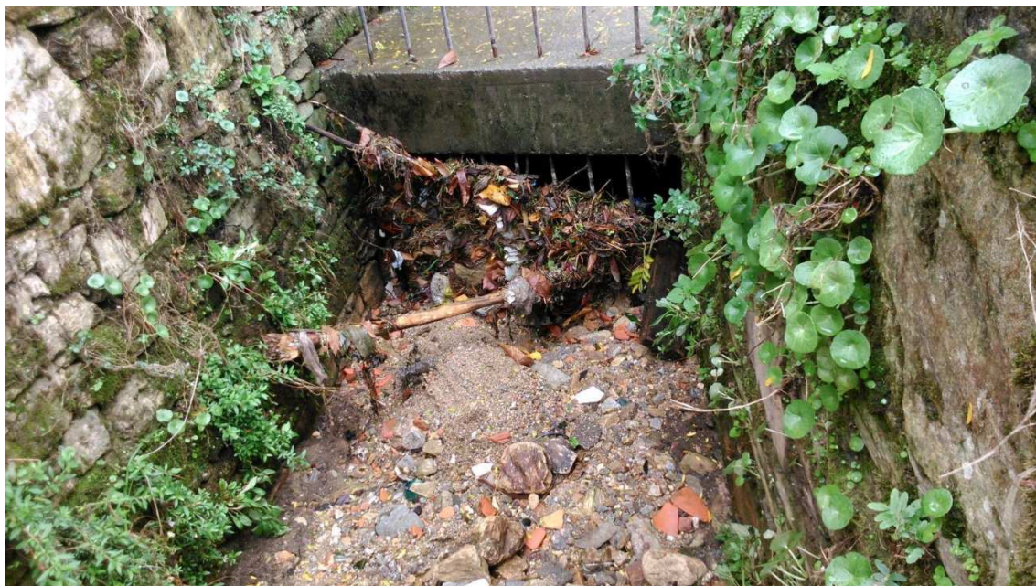
Estado actual da reixa
